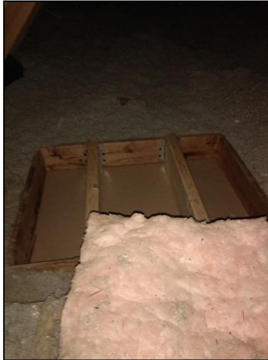
16. Gaps or voids
